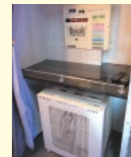
搭載した蓄電池
